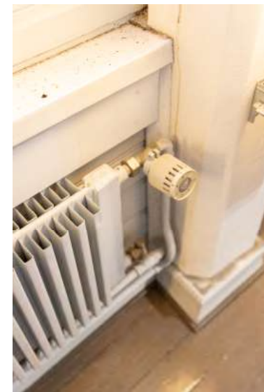
Kirkkosalin lämpöpatteri, HMT.
