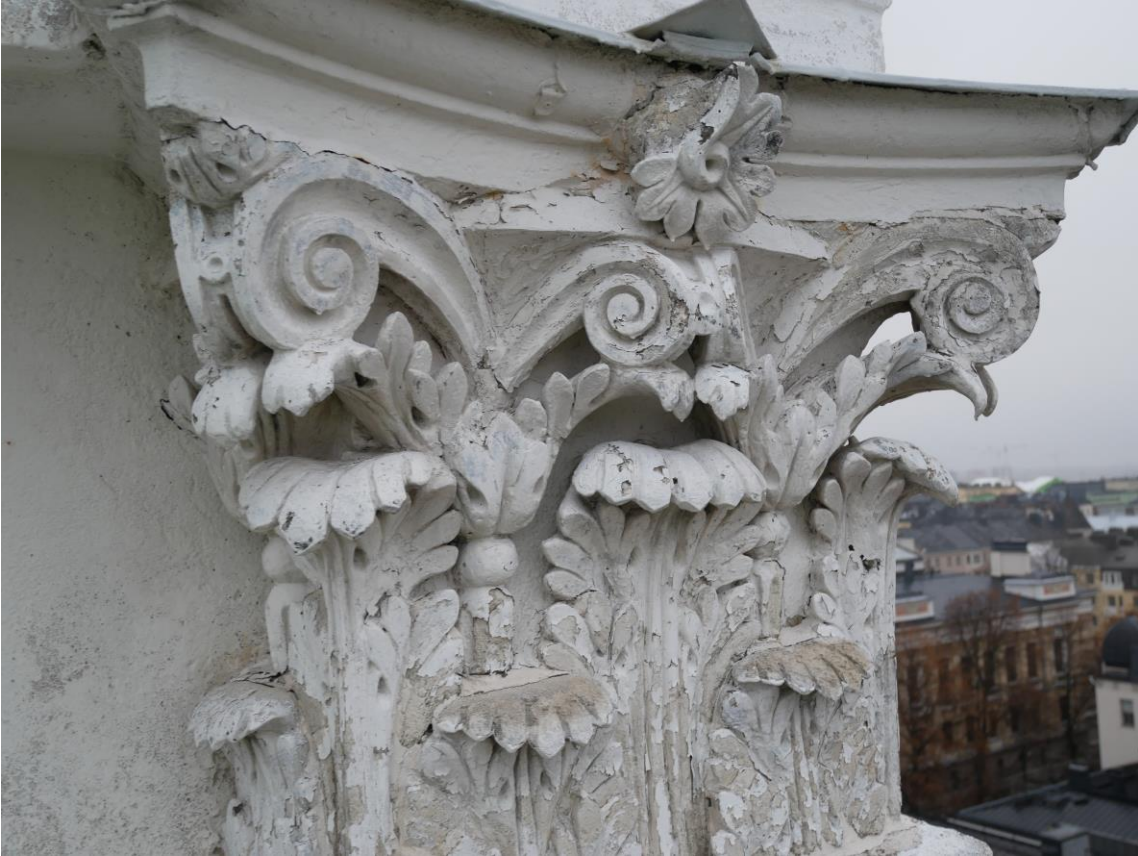
13. Vaurioituminen etenee jo laajasti
