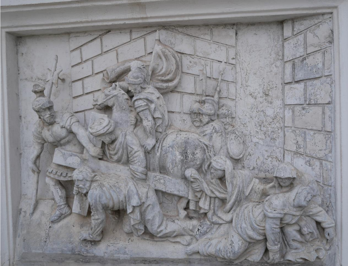
15. Reliefin maalipinta pahasti kulunut ja hilseilee
