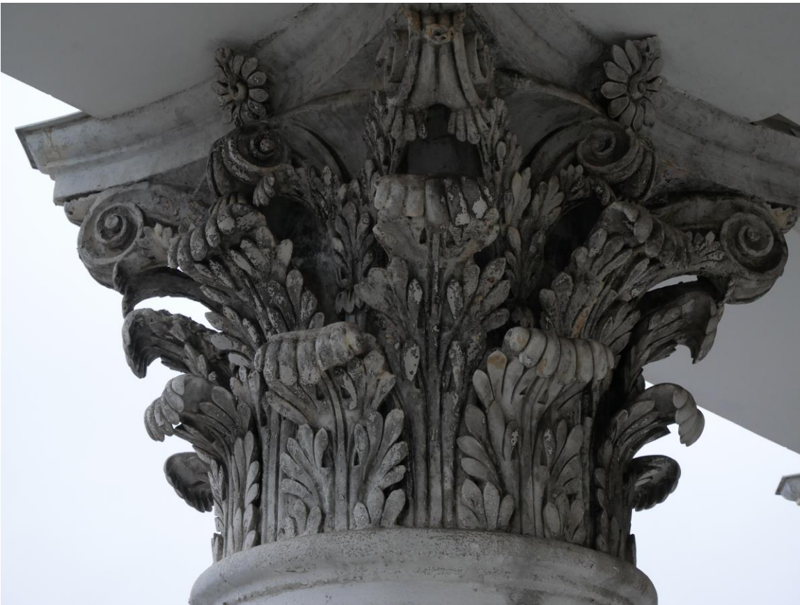
10. Suojassa olevan pylvään kapiteelin vaurioita ja voimakasta likaantumista
