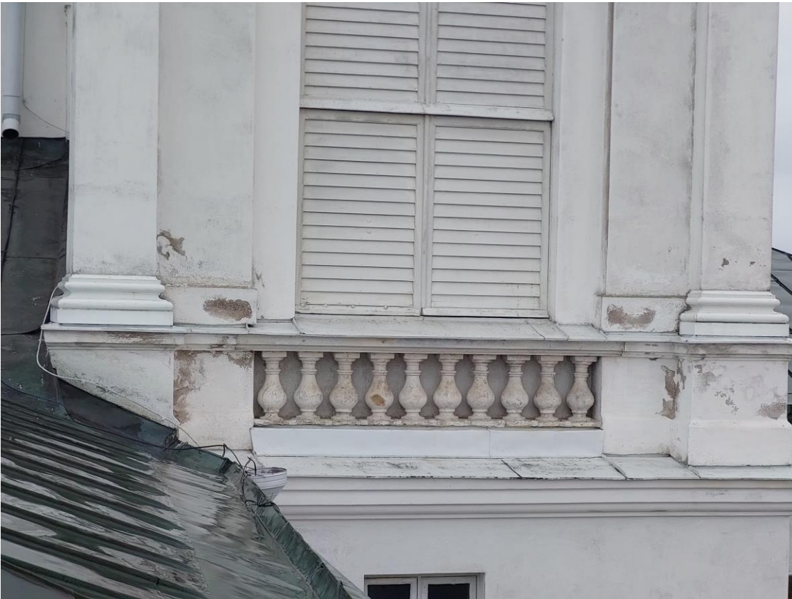
7. Tornien taustoissa jo selviä vaurioita
