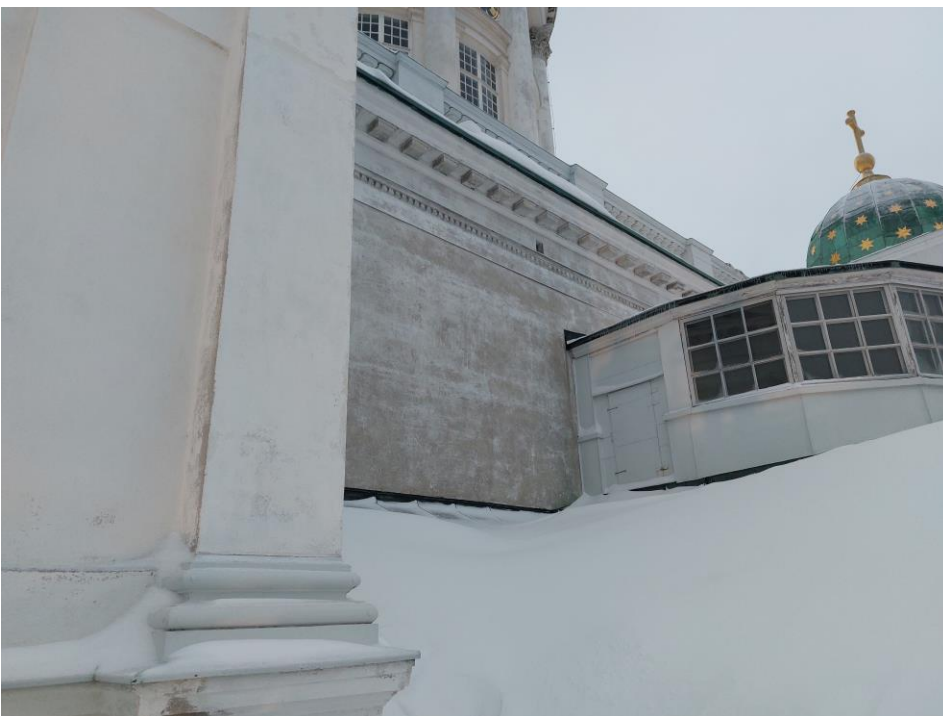
4. Maalipinta kulunut lähes kokonaan pois
