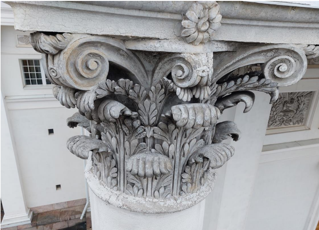
12. Maalaus kulunut pahasti, kapiteeli vielä aika ehjä Tuomiokirkon julkisivujen korjattavuusselvitys 2023
