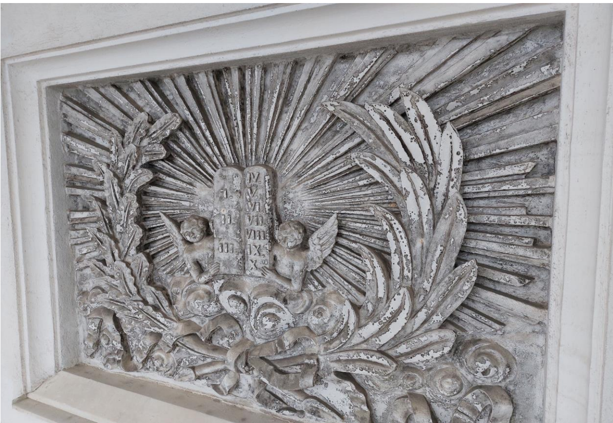
16. Reliefin maalipinta pahasti kulunut ja hilseilee
