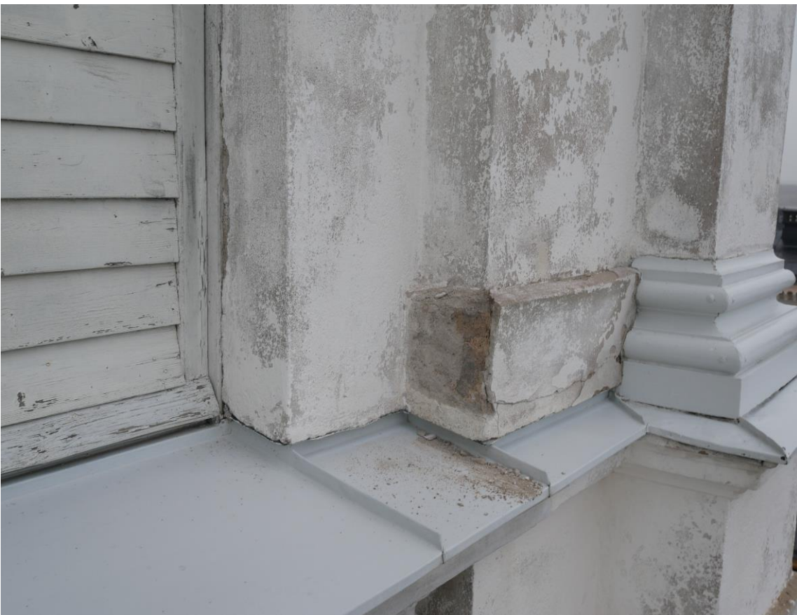
6. Piilossa olevia vaurioita tornin takapuolella
