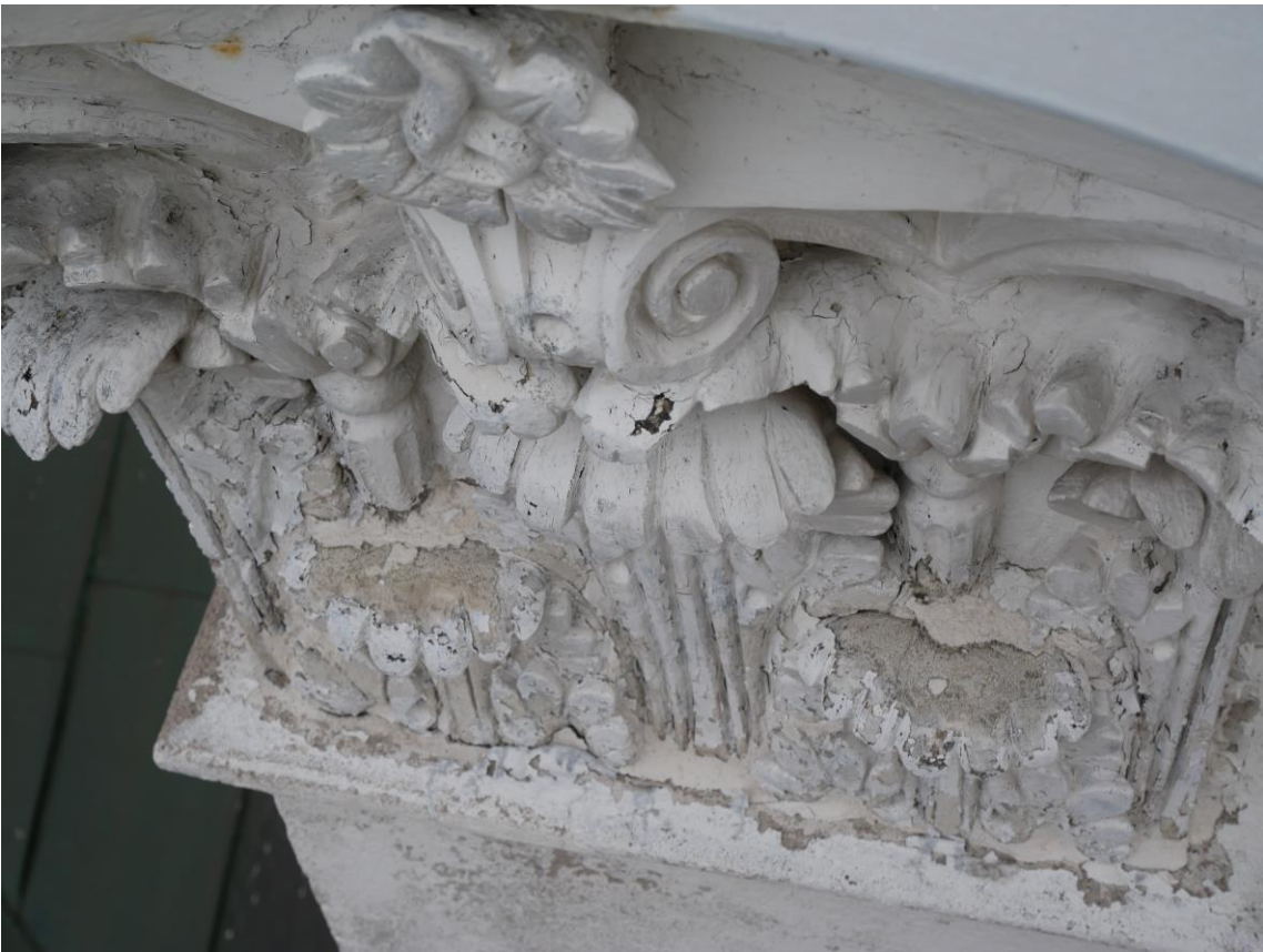
14. Päälipinnoilla lehvissä on jo pahoja vaurioita
