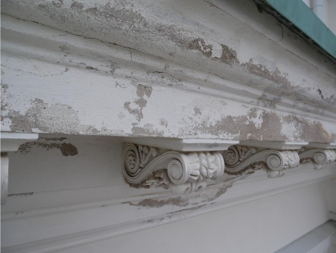
9. Rästaslistassa halkeamia ja maalipinnan kulumaa
